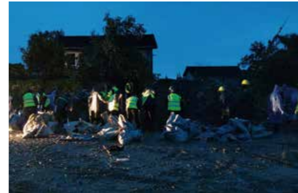
四公局天府大道北延线项目部昼夜驰援广汉市南丰镇汛灾河堤受损
