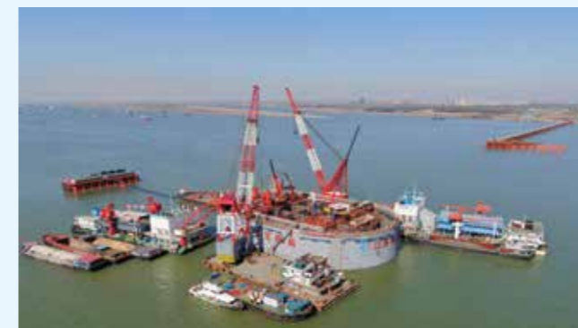
2 月 18 日，二航局参建的世界最大跨度公铁两用钢桁梁斜拉桥——常泰长江大桥主桥钢沉井夹壁混凝土开始首次浇筑
